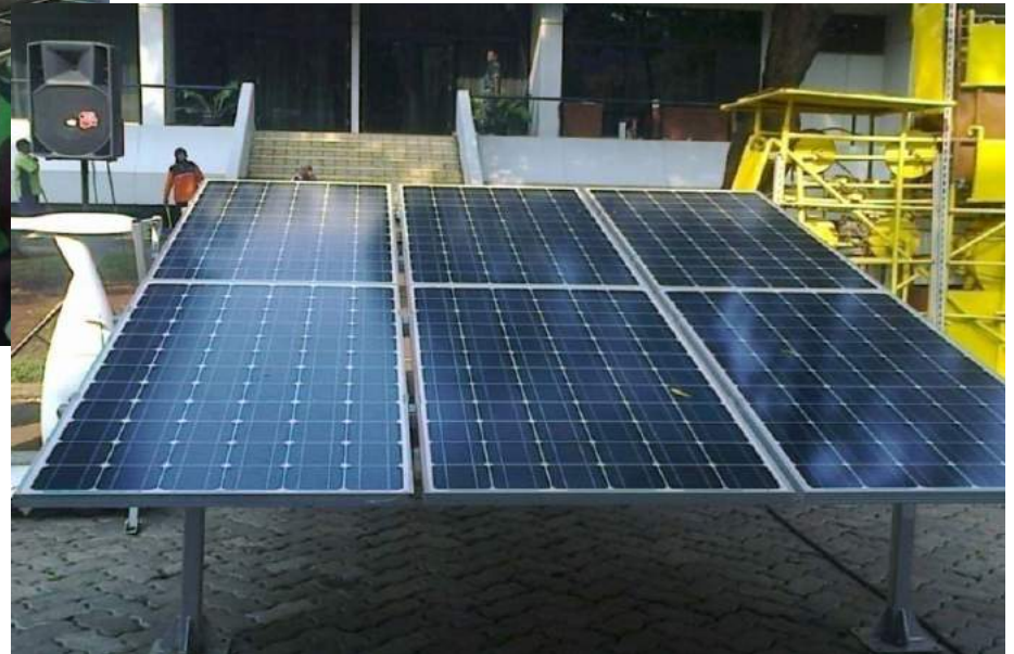
Gambar 9. Pembangkit Listrik Tenaga Surya Datar.
